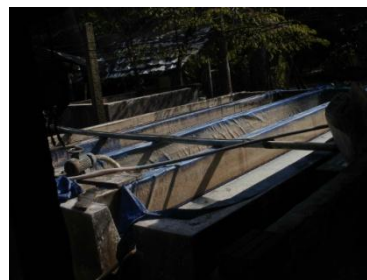
Hình 2.8.4. Bể lắng bột
